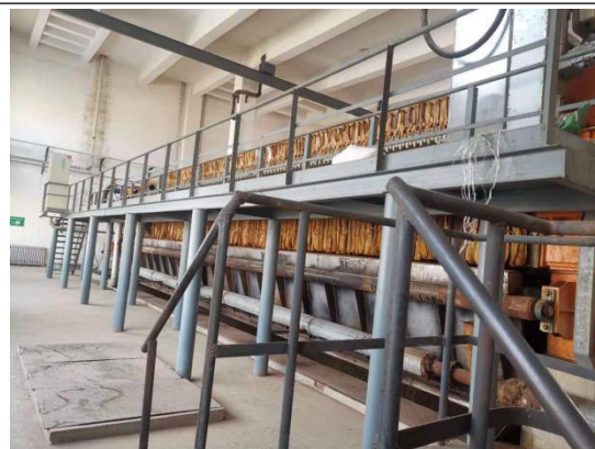
污泥脱水房，闲置
